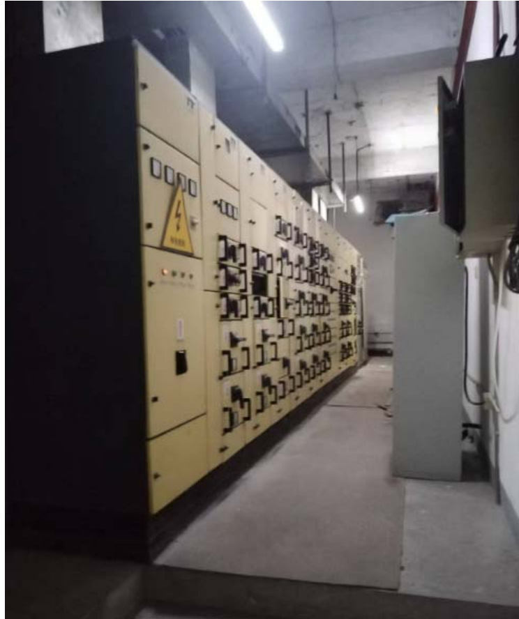
住院大楼配电室变配电设施现状图
